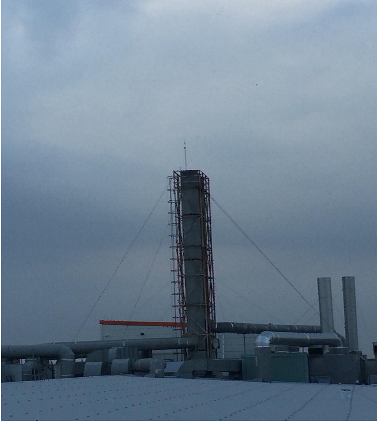
CHÔNG SÉT CÔNG TY WOOSUNG – KHU CÔNG NGHIỆP TRÀNG DUỆ
