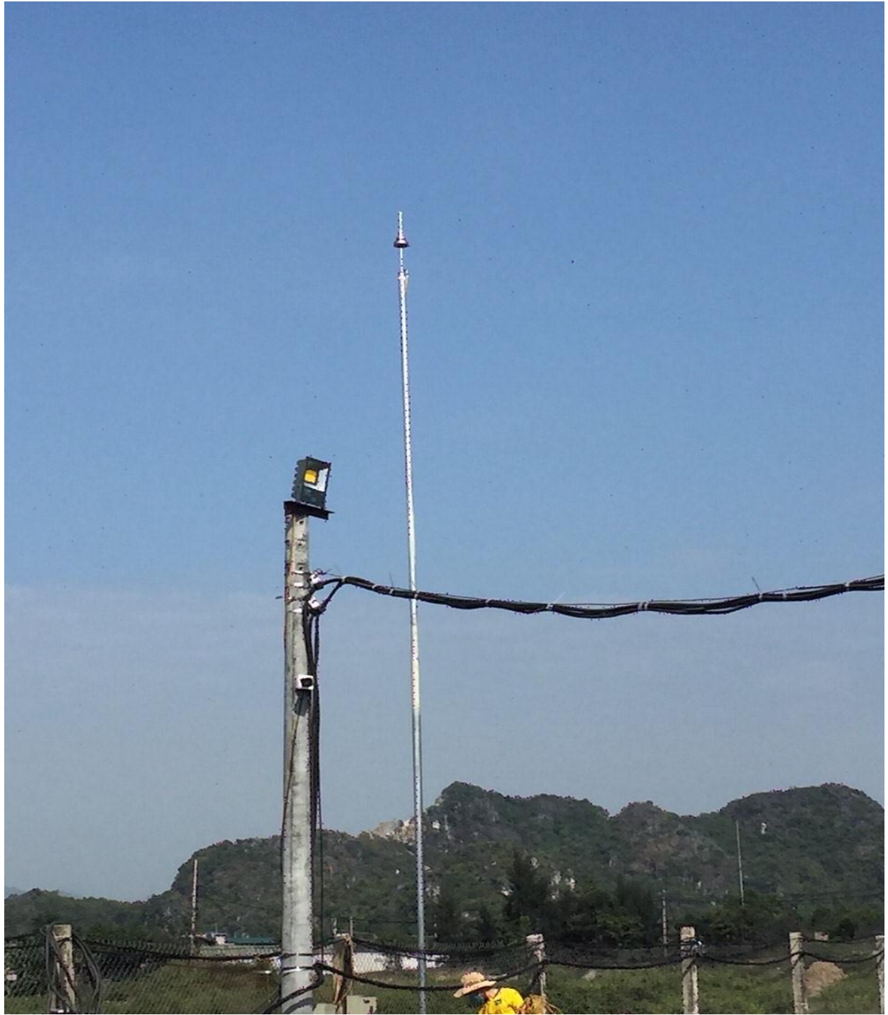
CHỐNG SÉT BÃI THAN CÔNG TY THÁI LÂM – THỦY NGUYÊN – HẢI PHÒNG
